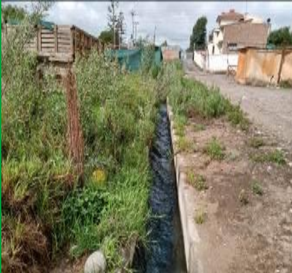
Ubicación del medidor RBC en el CD Tingo Grande
