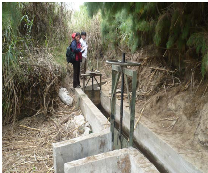
Foto: Cd 1 de mayo Bloque de riego Los Carricillos (cuenta con estructuras de control)
