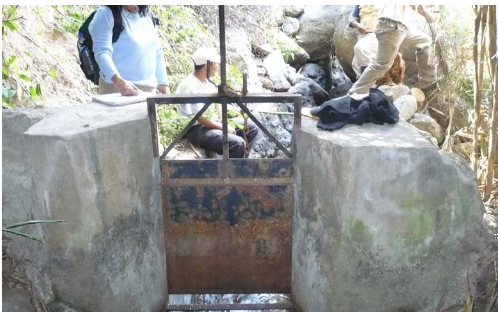
Foto: Estructura de Control, ubicada a 150 m de la toma de captación CD Canal Chorobal.
