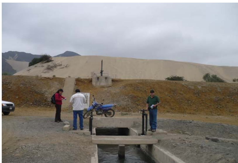
Foto: Estructura de medición y control Lateral 4.
